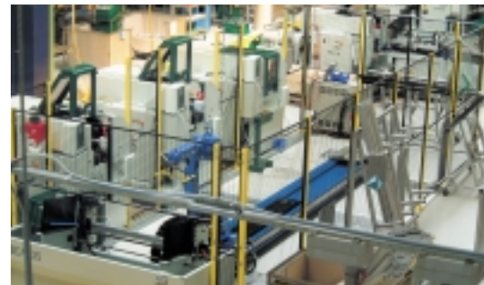
MOTOMAN UP 20 auf einer 5 Meter langen Fahrbahn zum Be- und Entladen von drei Rohrendbearbeitungsmaschinen
